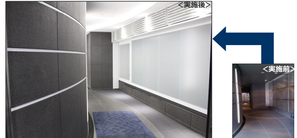
・2016年12月から2017年1月にかけてエントランスの改修工事を実施
