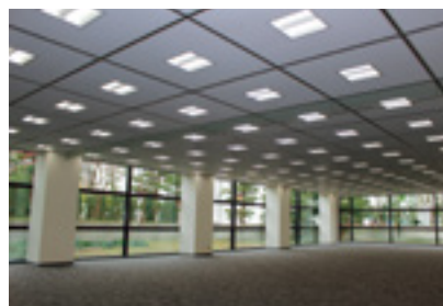
LED化工事後(世田谷ビジネススクエア)
