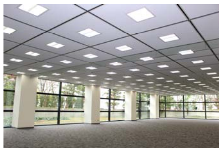
LED化工事後 (世田谷ビジネススクエア)
