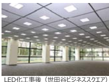
LED化工事後（世田谷ビジネススクエア）
